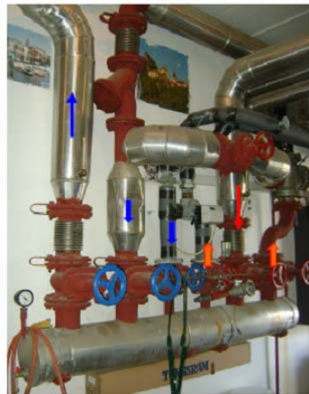
Колектор / распределител за топла вода со два круга за греење (стар и нов дел на објектот)
